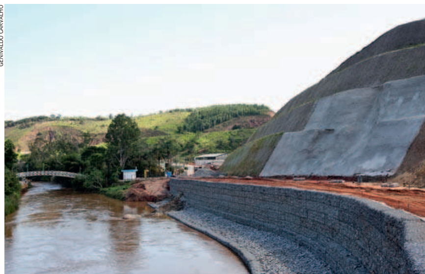
Problemas de escorregamento na Av. João Roman exigiram a construção de patamares e revestimento vegetal
