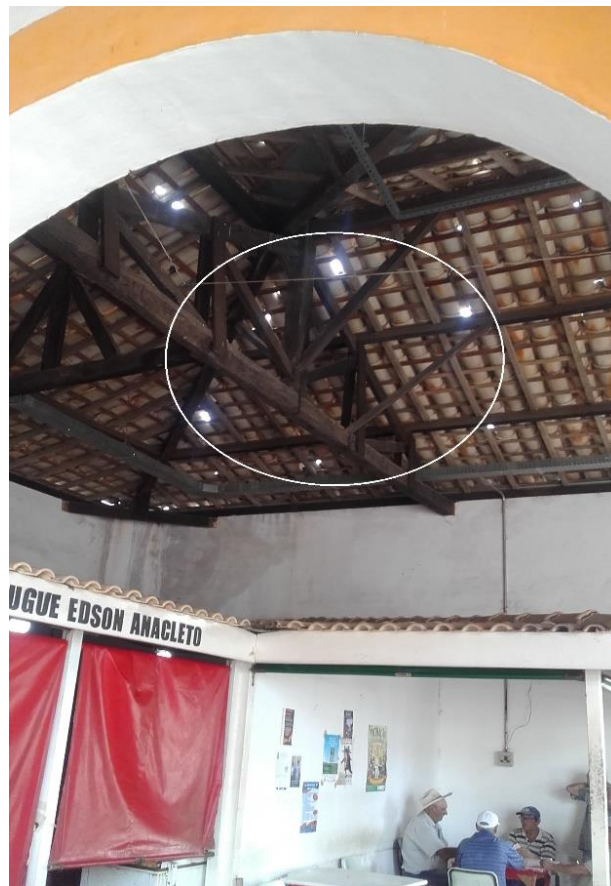
DETALHE DAS TELHAS DESLOCADAS – 2
