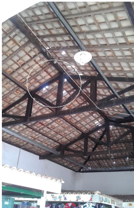
DETALHE DAS TELHAS DESLOCADAS – 1
