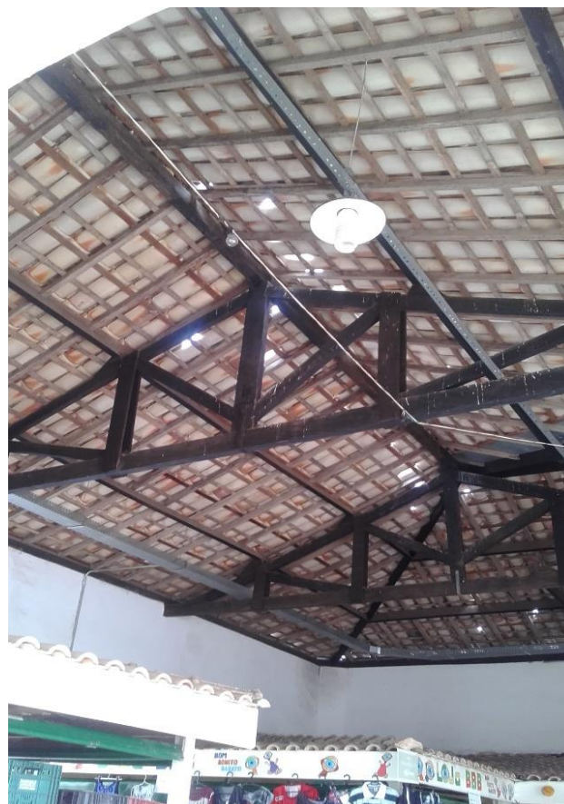
DETALHE DAS TELHAS DESLOCADAS – 3
